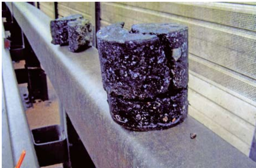
Рис. 1. Керн, отобранный из асфальтобетонного покрытия в месте образования трещины на вантовом мосту. Хорошо видно, что верхний слой из ЩМА треснул на всю толщину, а нижний слой из литого асфальтобетона сохранил целостность.
