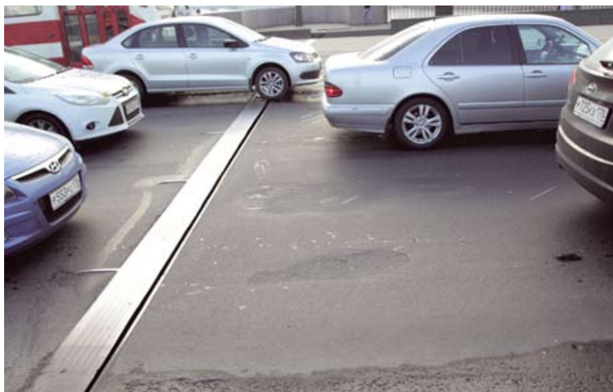
Деформации проезжей части мостового полотна
