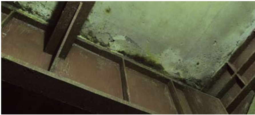
Плита перекрытия опоры разводного пролета, вид снизу, видны разрушения железобетона
