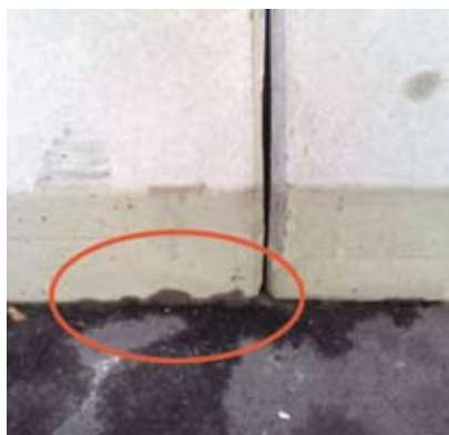
Рис. 2. Отсутствие вторичной защиты на блоках
