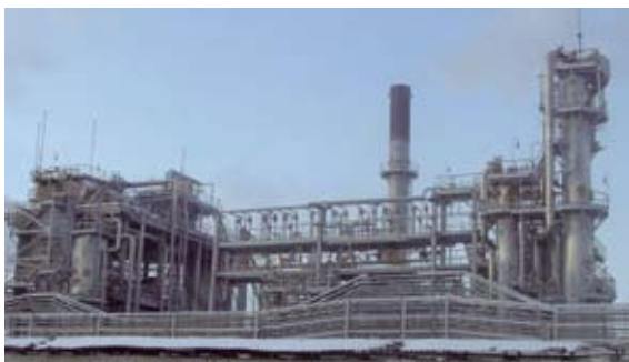
Установка деасфальтизации гудрона (тип 36/1 ОАО «Уфанефтехим»)
