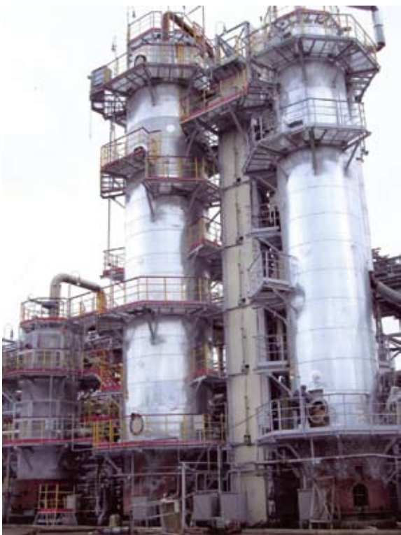
Установка производства битумов ОАО «Газпром-нефтехим-Салават» НПЗ, цех №14 Разработчик технологии и оборудования – ГУП «ИНХП РБ»
