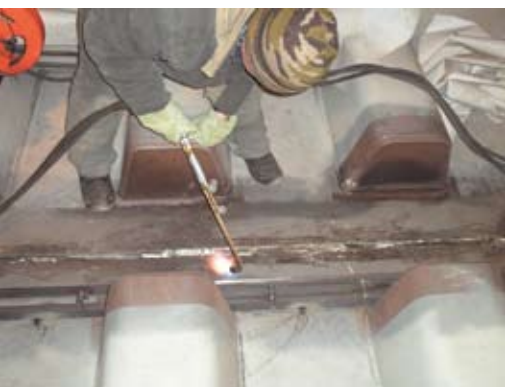
Рис. 7. Подготовка под сварку поперечного стыка монтажных панелей в створе оси мостового перехода
