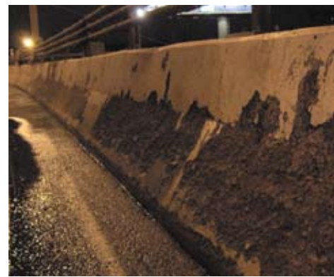
Рис. 3. Шелушение бетона и разрушение защитного паронепроницаемого покрытия
