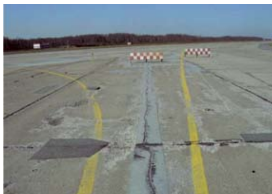
Рис. 1. Морозное воздействие на цементобетонное покрытие рулежной дорожки
