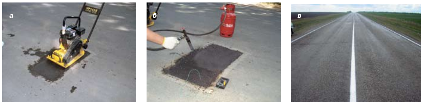
Рис. 3. Ремонт выбоины на дорожном покрытии с устройством защитного слоя: а — уплотнение смеси виброплитой; б — термическая обработка поверхности покрытия; в — общий вид отремонтированного участка после нанесения дорожной разметки
