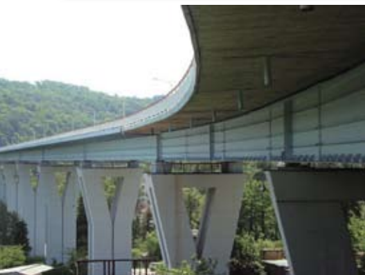
Рис. 3. Мост через реку Мацеста (состояние после 10 лет эксплуатации)
