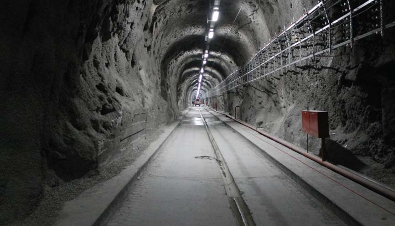
Многофункциональная штольня, обустроенная инженерными системами для временного пуска транспорта
