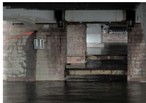
Рис. 8. Опоры моста Александра Невского (стрелкой указаны места протечек масла из механизмов разводного пролета)
