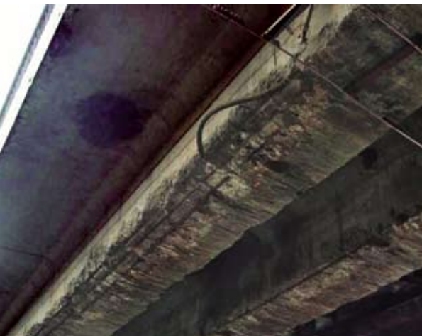
Рис. 11. Путепровод над Ленинским проспектом. Последствия ударов негабаритного автотранспорта
