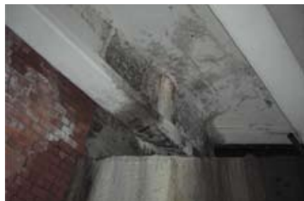
Рис. 2. Протечки сквозь строповочные отверстия балки, продукты коррозии бетона и арматуры
