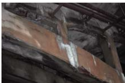
Рис. 3. Следы значительных протечек, выщелачивание бетона, оголение и коррозия арматуры
