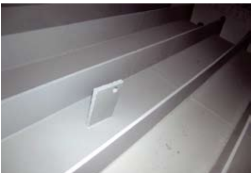
Рис. 5. Посторонний металлический предмет, приваренный к элементам конструкции
