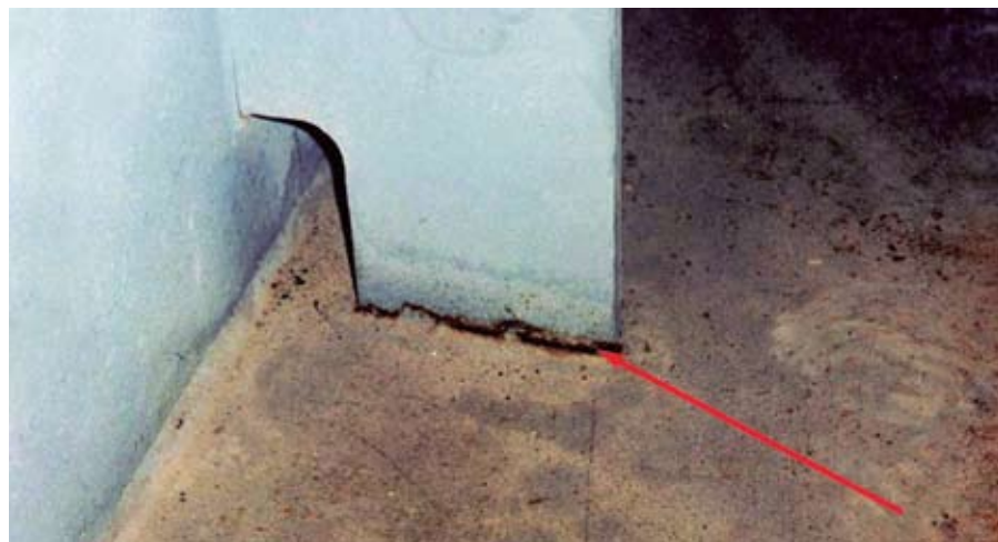
Рис. 2. Трещины в угловом сварном шве прикрепления вертикального ребра жесткости к нижнему горизонтальному листу коробчатого балочного неразрезного пролетного строения
