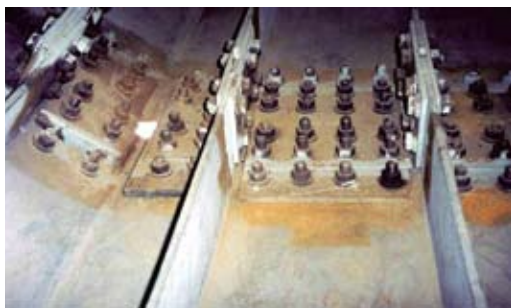
Рис. 4. Дополнительные прокладки сверхнормативной толщины
