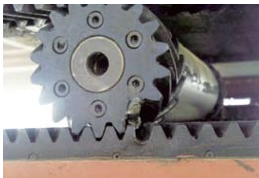
Рис. 3. Излом зубьев шеврона катковой опорной части на опоре 8
