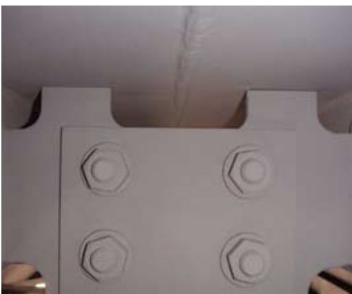
Рис. 6. Отсутствие углового сварного шва крепления роспуска поперечной балки проезжей части пролетного строения
