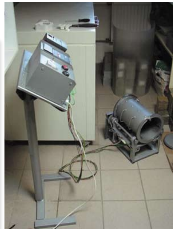
Рис.4. Установка АШМ рядом с морозильной камерой
