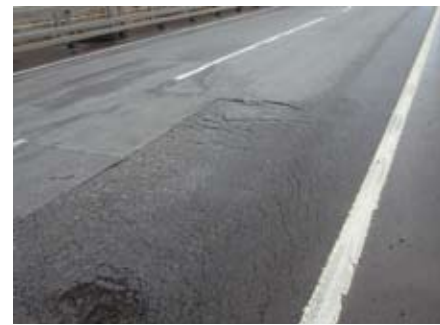
Рис. 1. Низкая адгезия асфальтобетона с напыляемой гидроизоляцией
