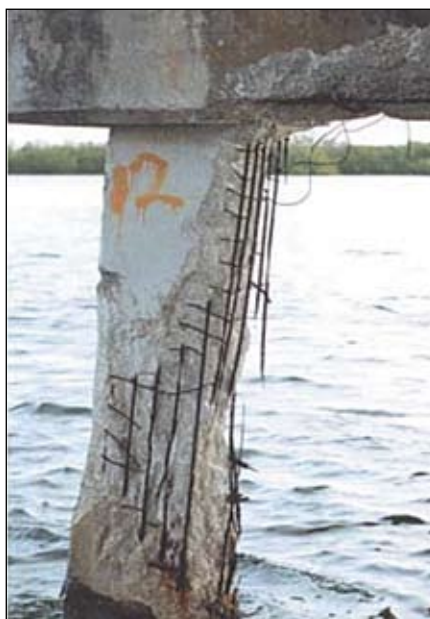
Рис. 8. Разрушение опоры. Коррозия бетона и арматуры
