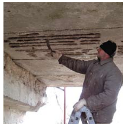
Рис. 7. Коррозия рабочей арматуры пролетного строения
