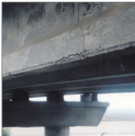
Рис. 6. Коррозия бетона. Нарушение защитного слоя
