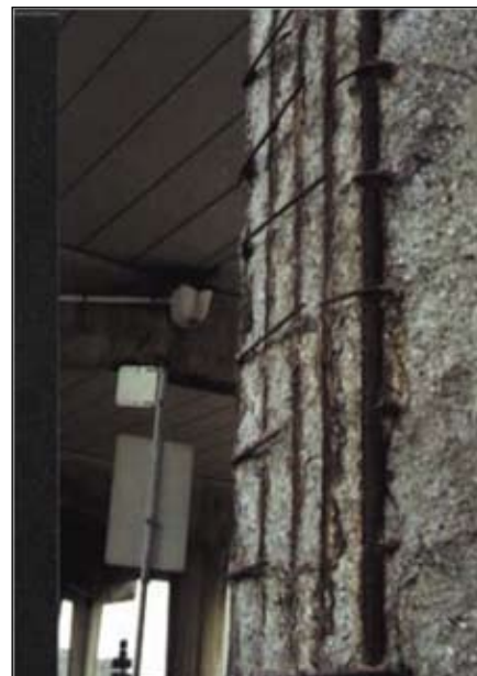
Рис. 9. Коррозия рабочей арматуры опоры путепровода
