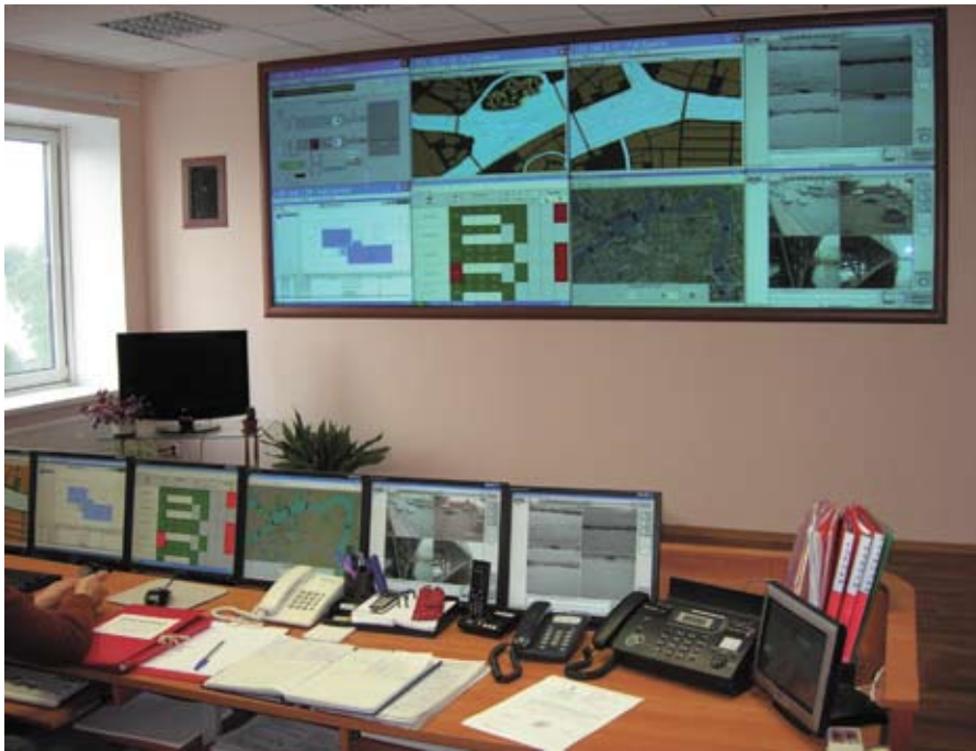
Рис. 3. Инженерно-диспетчерский центр СПб ГУП «Мостотрест»
