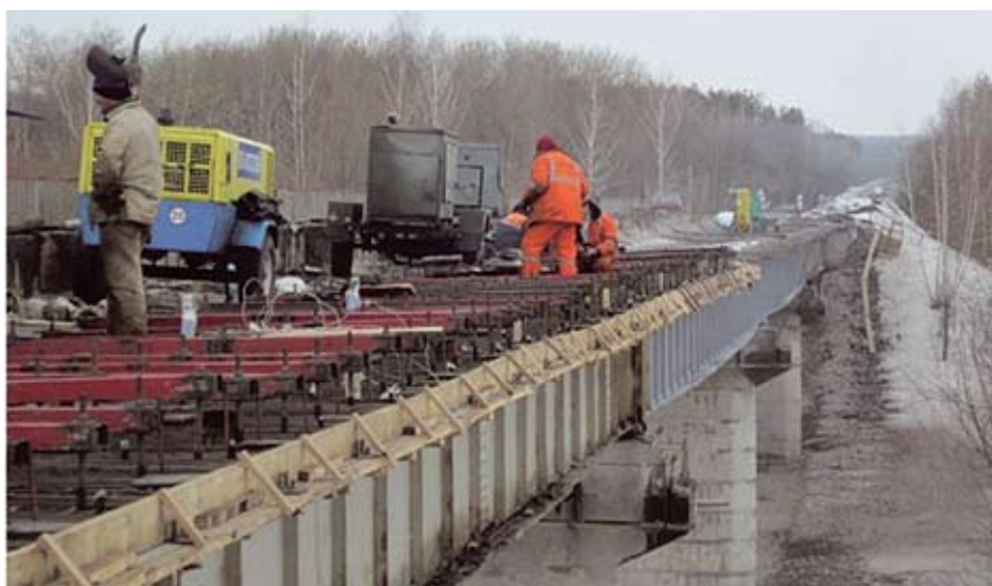
Использование системы АРМОКОТ 01 и АРМОКОТ F100 на мосту через реку Ворона в Кирсановском районе Тамбовской области
