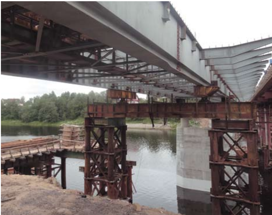
Капитальный ремонт моста через реку Сясь на км 515+372 автомобильной дороги А-114 Вологда – Новая Ладога до магистрали «Кола»
