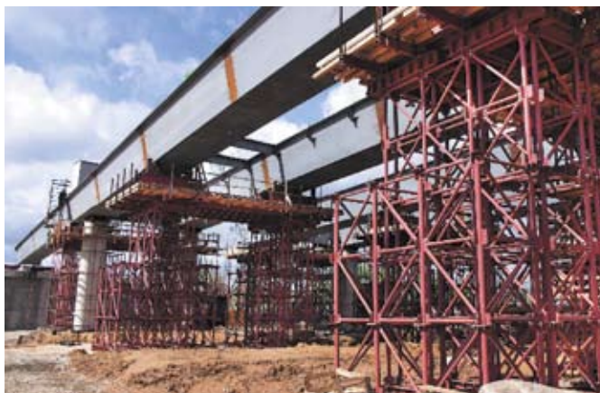
Мостовые опорные подмости (МОП 20) эстакады через Смоленскую железную дорогу и Можайское шоссе
