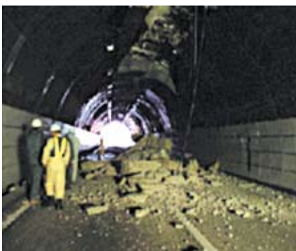
Рис. 6. Разрушенный автомобильный тоннель после землетрясения в Ниигате (Япония), 2004 год
