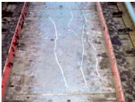
Рис. 4. Трещины в плите безбалластного мостового полотна
