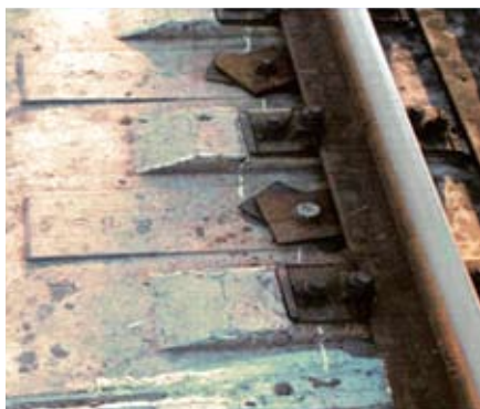
Рис. 5. Трещины в плите безбалластного мостового полотна по отверстиям крепления шпилек
