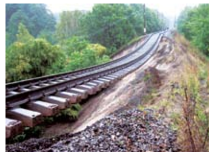
Рис. 2. Сплыв откоса насыпи на Калининградской железной дороге, произошедший вследствие землетрясения
