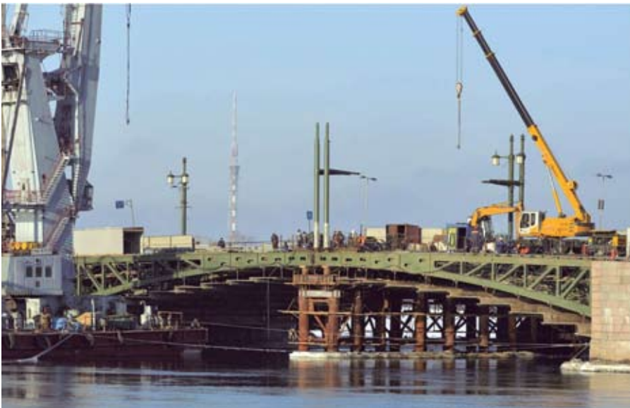
Вывешивание замковой части разводного пролета на временной опоре, смонтированной в русле реки
