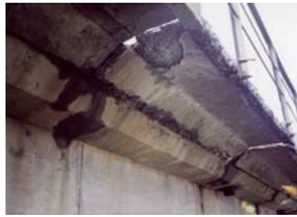
Рис. 5. Разрушение тротуарной плиты моста
