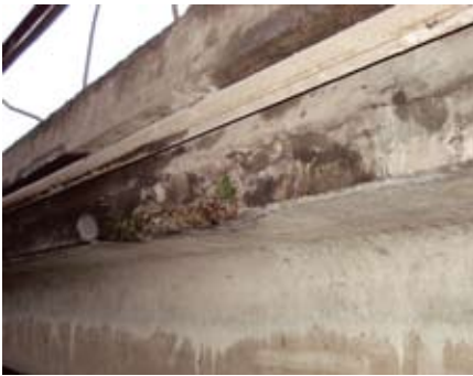
Рис. 2. Разрушение и коррозия бетонной балки пролетного строения моста
