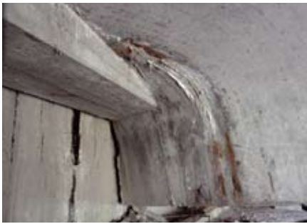
Рис. 4. Следы выщелачивания бетона и коррозии арматуры балки пролетного строения
