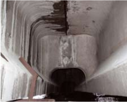
Рис. 1. Следы протечек через стык между балками и выщелачивания бетона
