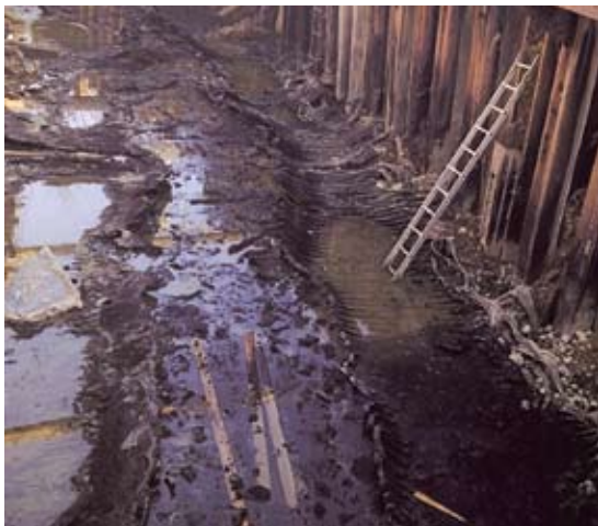
Последствия пожара на стройплощадке водоотводящего коллектора Хлудовского ручья
