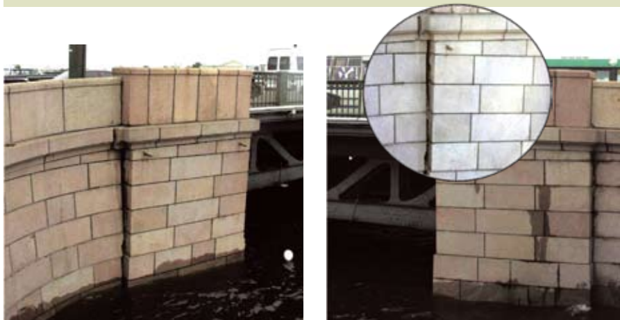
Неудовлетворительное состояние береговых опор (устоев) моста в связи с деформациями (креном) в сторону русла
