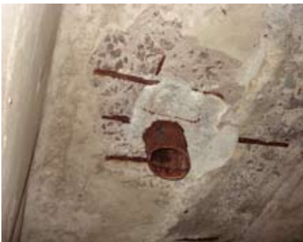
Рис. 3. Разрушение защитного слоя и коррозия арматуры в зоне водоотводной трубы
