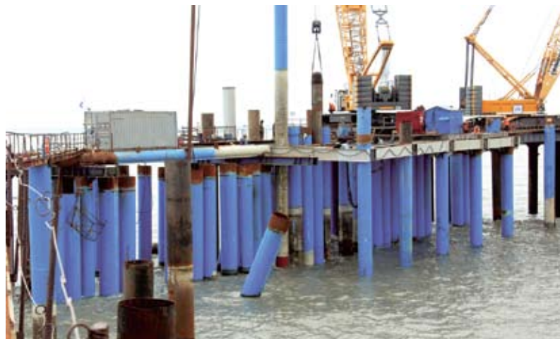
Повреждения конструкций в строящемся грузовом порту, произошедшие в результате шторма
