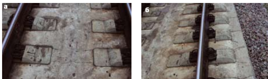
Рис. 2. Ориентированные, строго локализованные трещины в несущей плите безбалластной конструкции на участке Саблино — Тосно
