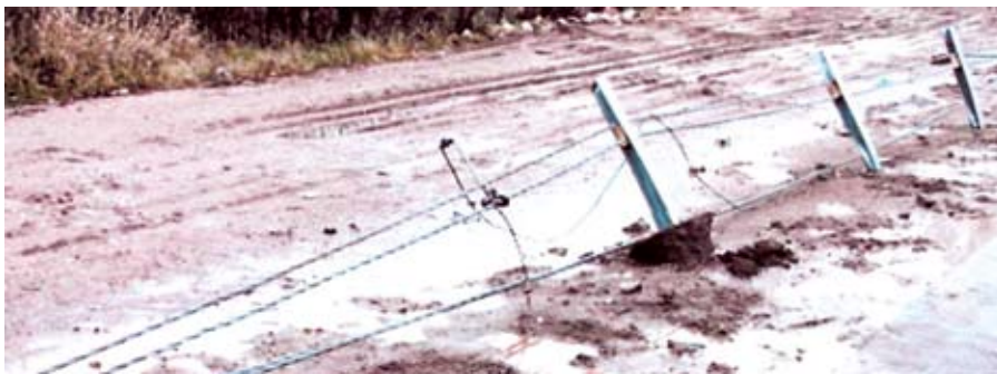
Рис. 7. Выход фундамента с гильзой и стойкой из грунта при слабом водонасыщенном грунте (испытания на полигоне)
