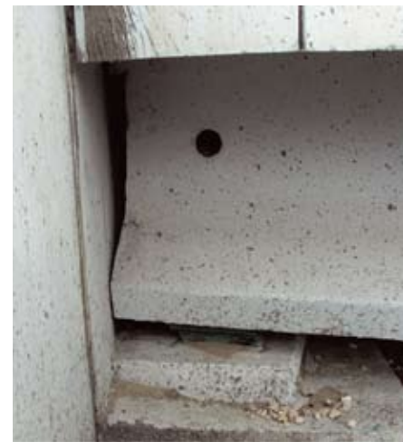
Рис. 7. Отсутствие зазора между шкафной стенкой и балками пролетного строения
