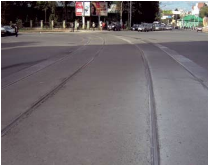
Рис. 4. Состояние дорожного покрытия после 5 лет эксплуатации (г. Пермь, ул. Куйбышева)
