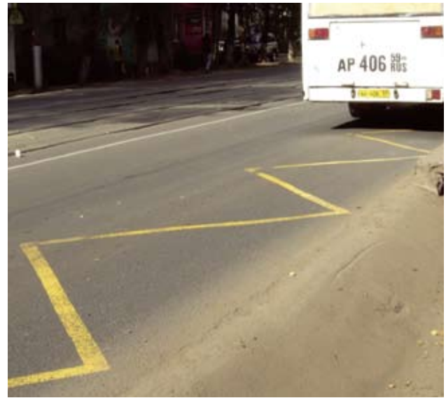
Рис. 5. Состояние дорожного покрытия после 5 лет эксплуатации (г. Пермь, ул. Карпинского)
