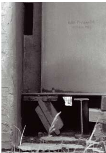
Рис. 4. Пролетное строение моста уперлось в шкафную стенку, опорная часть приняла наклонное положение. Мост через р. Дон, 1995 год
