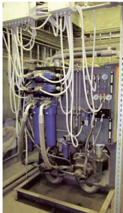
Основная насосная станция Ладожского моста
