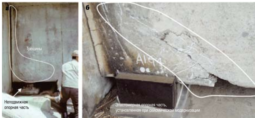
Рис. 9. Повреждение преднапряженной балки моста Юридж в зоне опирания: а — землетрясение Мияги-Кен-оки 1978 года, б — Великое восточно-японское землетрясение 2011 года
