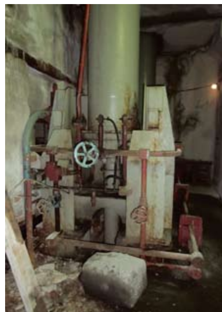
Гидроцилиндр механизма разводки до ремонта моста
