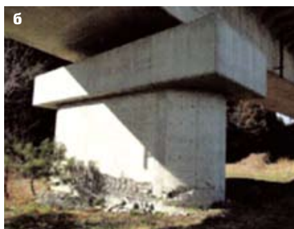
Рис. 6. Изгибно-сдвиговые разрушения тела опор из-за недостаточной протяженности продольных стержней: а — мост Фудзи; б — мост Есаки
