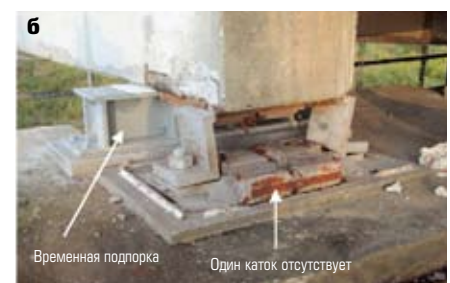
Рис. 8. Повреждения стальных катковых опорных частей моста Юридж: а — землетрясение Мияги-Кен-оки 1978 года; б — Великое восточно-японское землетрясение 2011 года
