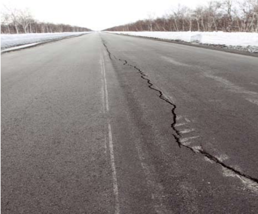
Рис. 1. Продольная трещина по оси дорожного покрытия автомобильной дороги Петропавловск-Камчатский — Мильково
