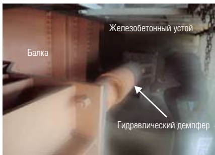
Рис. 15. Гидравлический демпфер установлен как элемент сейсмического модифицирования
