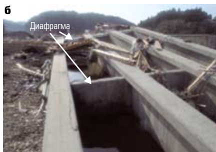
Рис. 20. Разрушение пролетов S5–S10: а — пролеты S5–S7; б — перевернутый пролет S8
