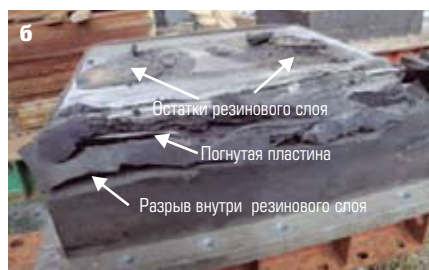
Рис. 17. Мост Сендай-Тобу: а — разрыв эластомерных опорных частей; б — характерный тип разрушения
