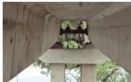
Сейсмозащита пешеходного моста
