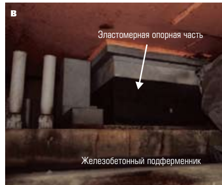
Рис. 14. Эффективность замены стальных опорных частей на эластомерные: а и б — повреждение опорных частей при землетрясении в Мияги-Кен-Оки в 1978 году; в — эластомерная опорная часть после Великого восточно-японского землетрясения 2011 года
