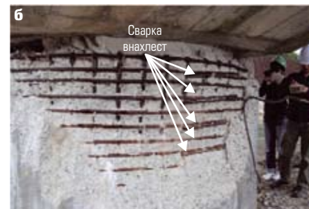
Рис. 21. Результаты смещения пролета S3 на опоре P2: а — разрушения стальных упоров; б — разрушение тела опоры P2 от сжимающих усилий при изгибе
