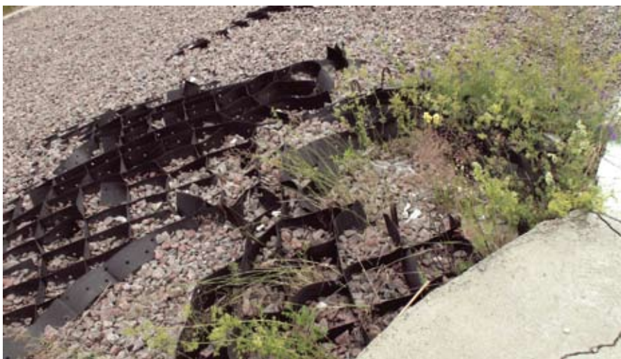
Рис. 4. Типовые многочисленные локальные повреждения георешетки на конусе моста
