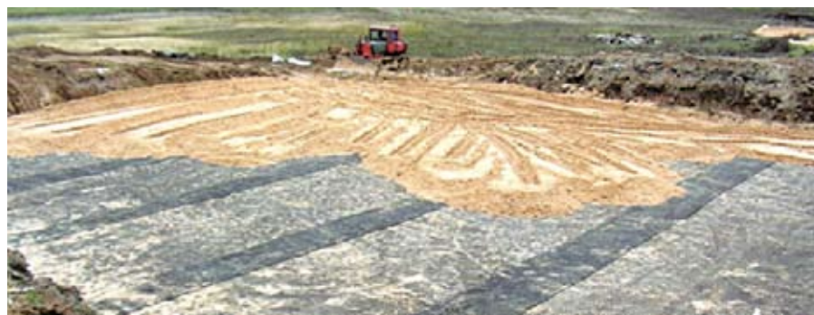
Рис. 4. Противокарстовые мероприятия на км 13+600 автодороги «Павлово — Сосновское — Лесуново — Мухтолово — Саконы» в Сосновском районе Нижегородской области
