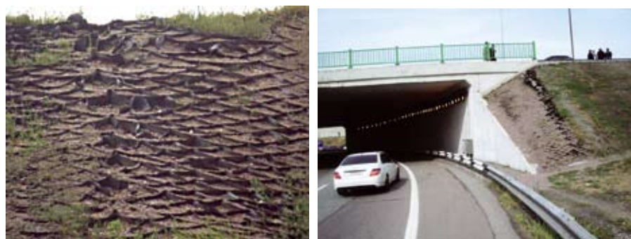
Рис. 2. Последствия ползучести полиэтиленовых георешеток
