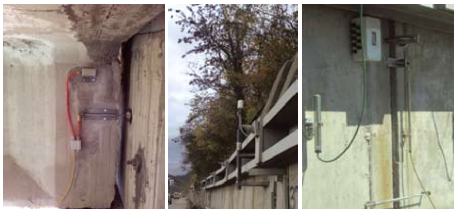
Оборудование системы контроля деформаций и смещений объектов трассы М-27 Джубга — Сочи
