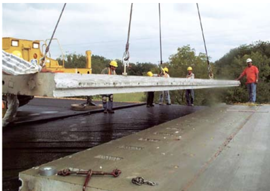
Рис. 2. Подача бетонной плиты сборного типа на дорожное земляное полотно с подсыпкой дренирующего песчаного слоя, укрытого полиэтиленовой пленкой. По торцу плиты видны отверстия для ввода стягивающих стальных канатов (США, штат Техас)
