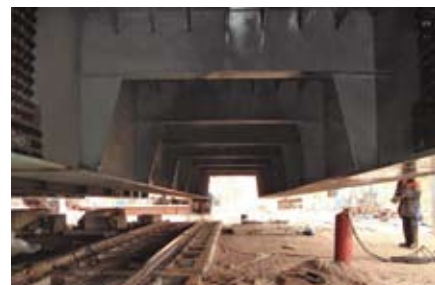
Поднятая консоль конца пролета и железобетонные плиты с накаточными путями под тележки
