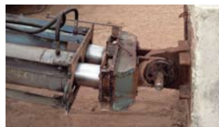
Опорный узел силовых домкратов и якоря
