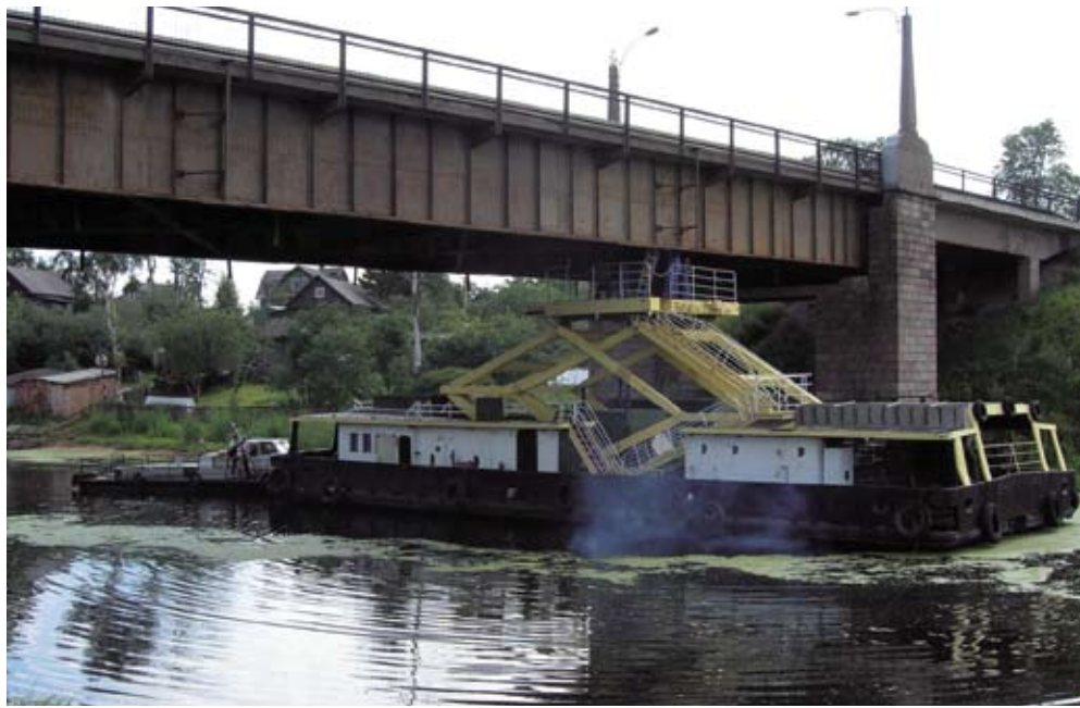
Рис. 3. Плавучая ремонтная база
