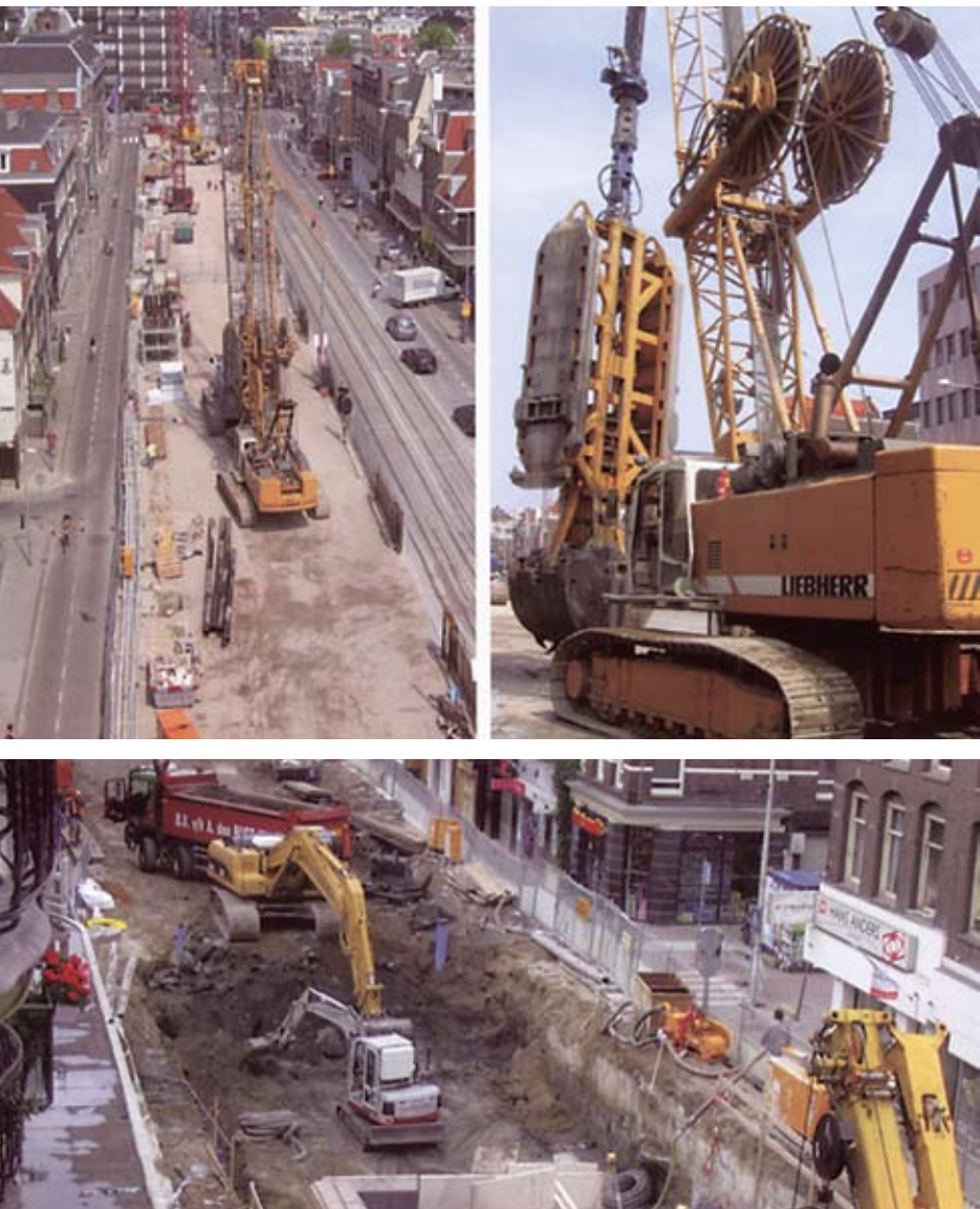
Рис. 2. Процесс возведения открытого котлована в Амстердаме, в том числе, без остановки движения транспорта
