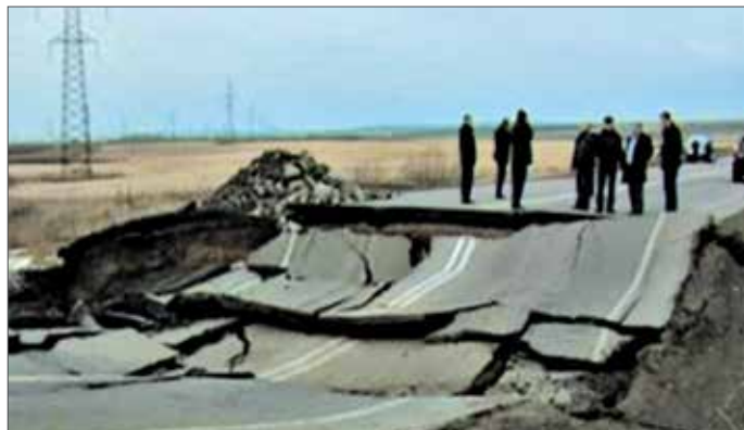
Рис. 1. Разрушения на федеральной дороге М-55 «Байкал» (недоучет грунтовых условий)
