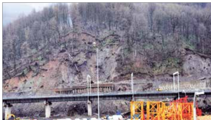
Рис. 2. Оползневой процесс на участке совмещенной железной и автомобильной дороги Сочи – Красная Поляна
