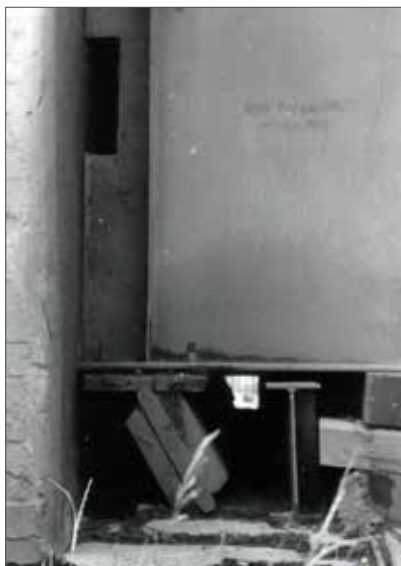
Рис. 1. Пролетное строение моста через р. Дон уперлось в шкафную стенку; наклонное положение опорной части (1995 г.)
