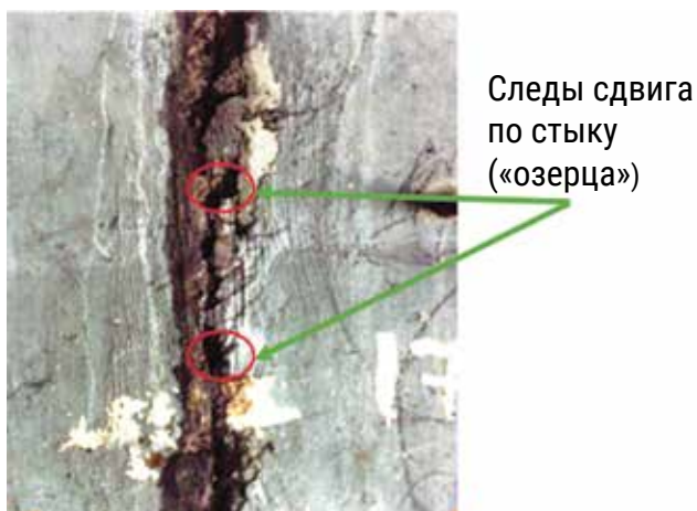
Рис. 4. Трещина в поперечном стыке пролетного строения Ворошиловского моста через р. Дон (Ростов-на-Дону)
