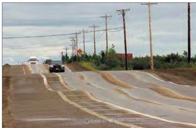
Рис. 1. Дорожная насыпь, деформированная вследствие неравномерной осадки протаявших грунтов основания
