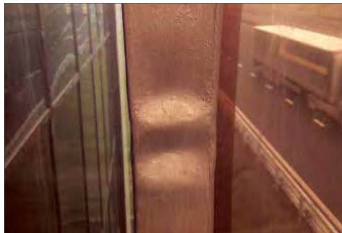
Рис. 5. Строительный контроль пропустил конструктивный брак — гофрирование при гибке; следовало применить гибку с растяжением, не позволяющую терять устойчивость формы
