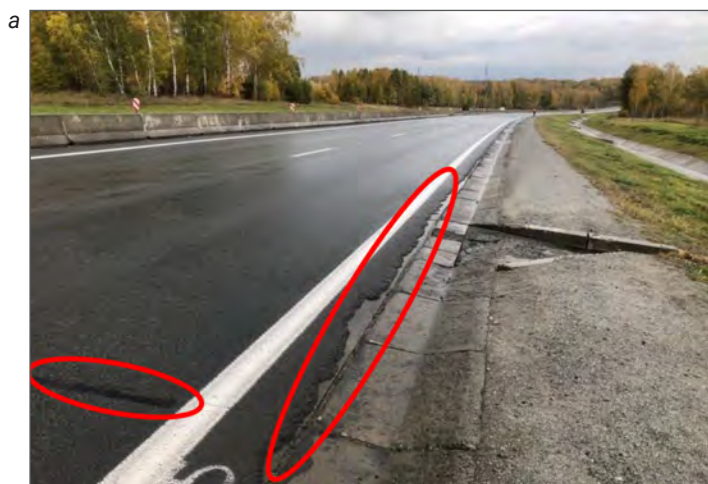
1. Отраженные трещины через 15-20м шириной раскрытия до 0,5 см 2. Отслаивание асфальтобетона по кромке покрытия в местах отсутствия фрезерования
