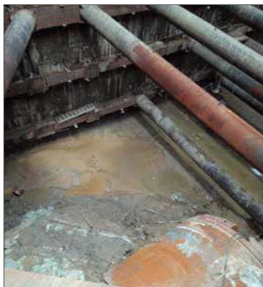
Рис. 1. Аварийный выход водогрунтовой массы в котлован
