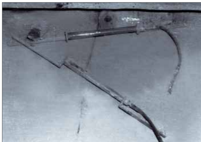
Рис. 4. Деформометры ПЛДС-400 на одиночной трещине в блоке
