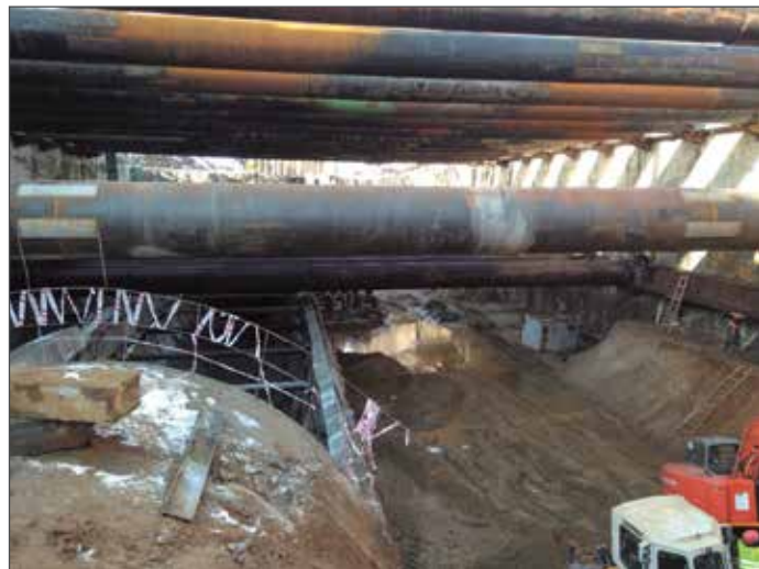
Рис. 2. Ввод ТПМК в котлован до разработки грунта, последующая откопка ТПМК и разборка тоннеля
