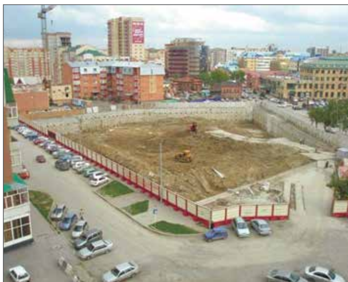
Устройство подземной части комплекса зданий по технологии «стена в грунте» (г. Тюмень)
