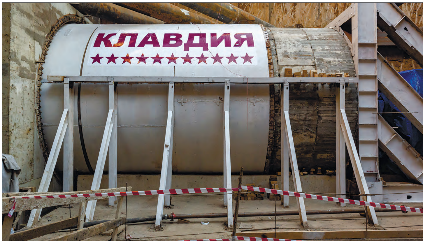
12-й старт легендарного ТПМК Lovat-242SE с именем «Клавдия» для сооружения правого перегонного тоннеля между станциями «Улица 800-летия Москвы» и «Лианозово» ЛДЛ
