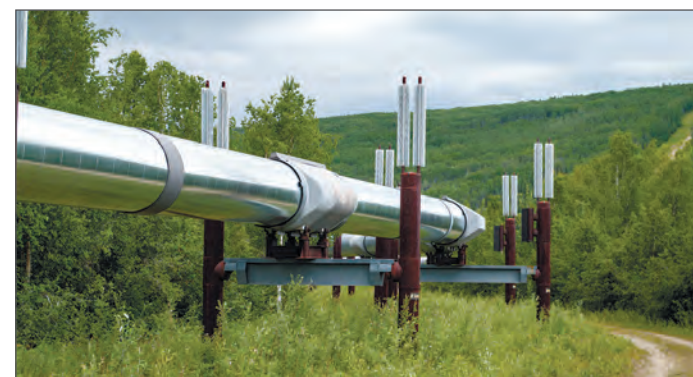
Система термостабилизации, устроенная вдоль трубопровода (Канада).
