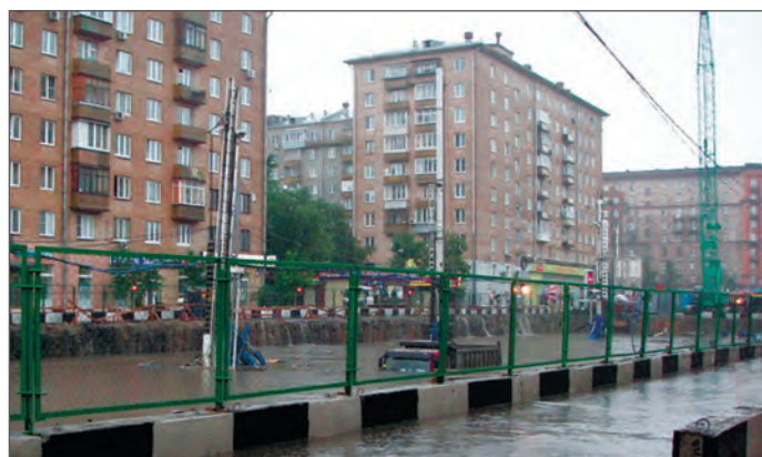
Рис. 6. Затопление строительного котлована и прилегающих временных дорог в результате обильных осадков
