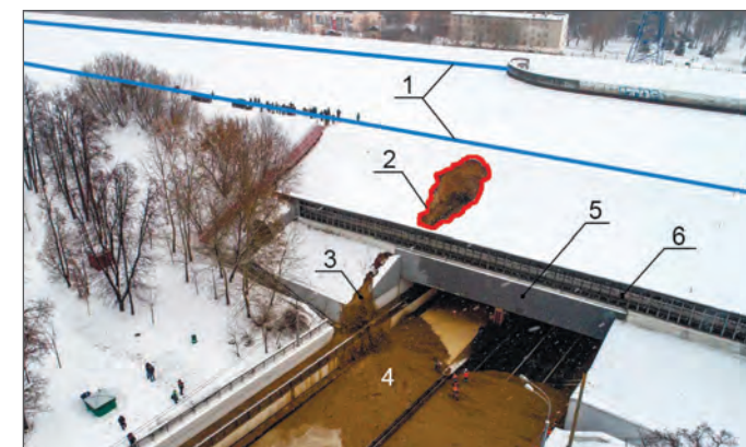
Рис. 1. Прорыв воды через разрушенный откос дамбы канала: 1 – границы канала; 2 – границы зоны обрушения грунта на откосе дамбы; 3 – переливание водогрунтовой массы через стенки припортальной части тоннеля; 4 – грунтовые наносы на проезжей части тоннеля; 5 – портал тоннеля; 6 – пешеходный переход над тоннелем
