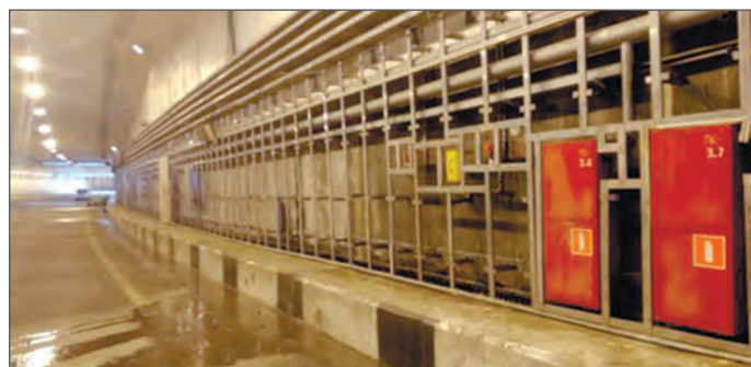
Рис. 11. Протечки по стене тоннеля с выходом воды на проезжую часть
