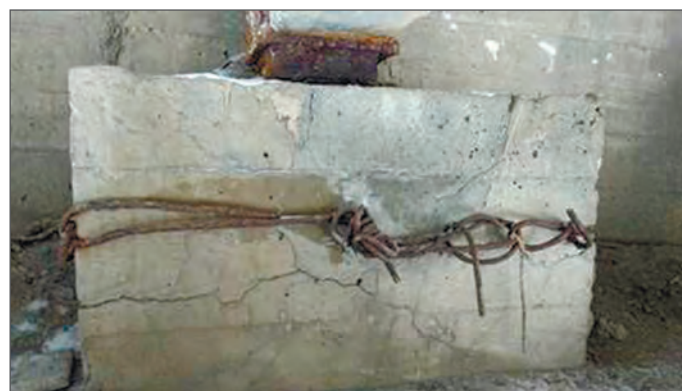
Недостаточное армирование подферменника привело к растрескиванию и отламыванию больших фрагментов бетона. На фото — временный ремонт, препятствующий дальнейшему разрушению подферменника. Но, к сожалению, «нет ничего более постоянного, чем временное»
