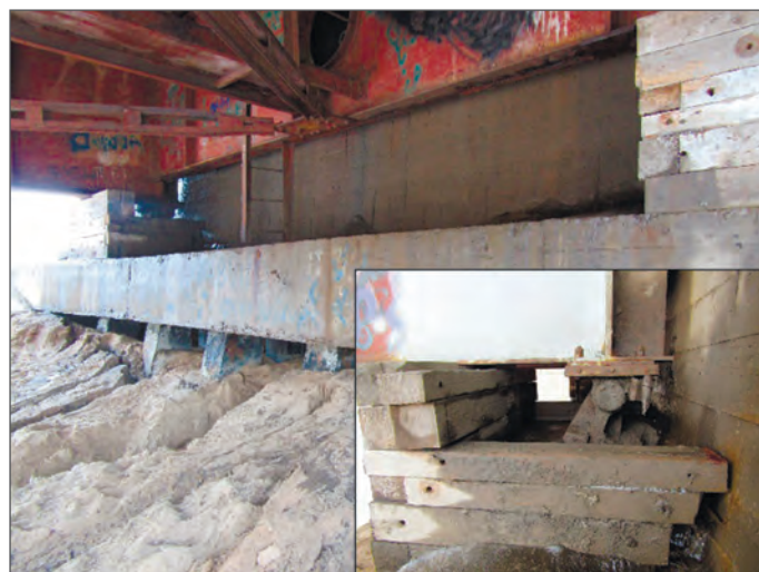
Критический угол наклона балансира с установленной по периметру страховочной клетью на случай обрушения опорной части
