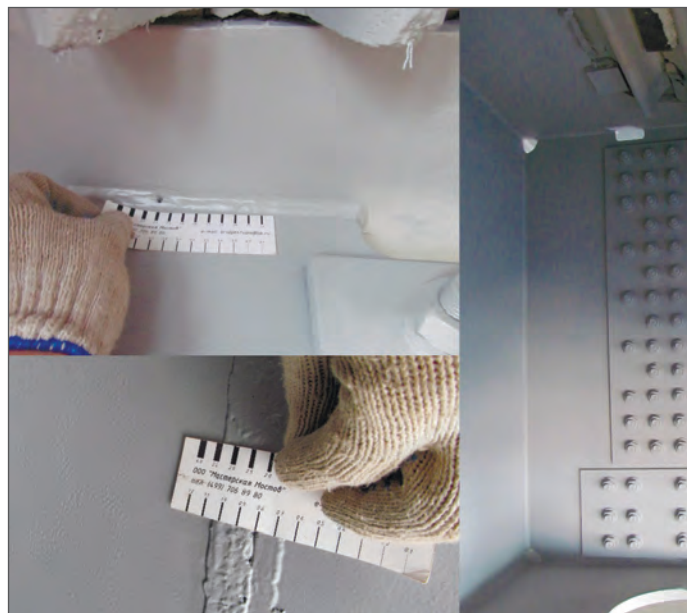
Поры в сварных швах, непровары и другие дефекты в ответственных конструкциях
