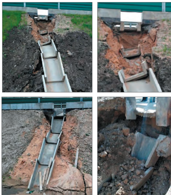
Рис. 1. Характерные разрушения типовых конструкций поперечного дорожного водоотвода
