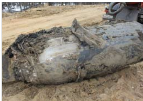
Вид оголовка трубы без покрытия «ЗУБ-Композит»
