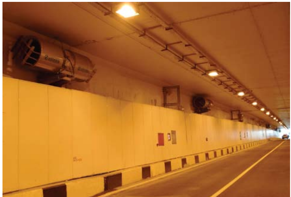
Рис. 1. Применение струйных вентиляторов в Алабяно-Балтийском автомобильном тоннеле (Москва)
