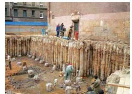
Рис. 3. Пример устройства ограждений методом «стена в грунте» касательных и секущихся буронабивных свай в центре Санкт-Петербурга
