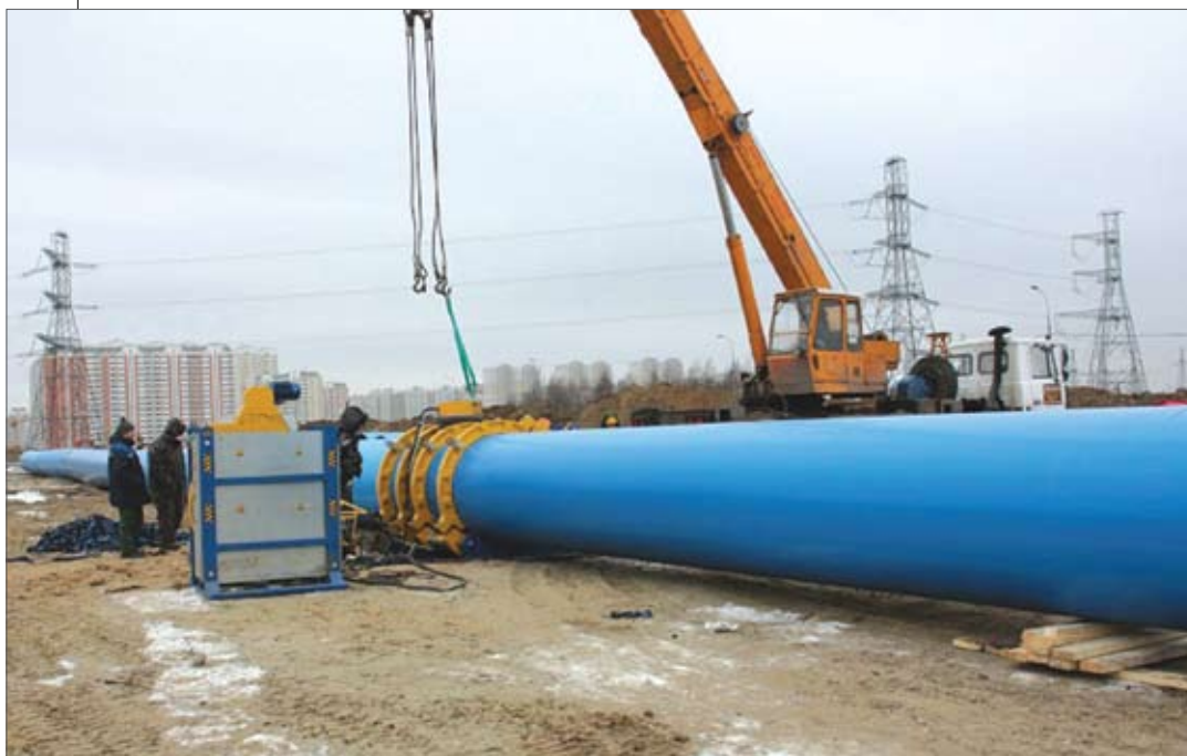
Рис. 1. Строительство ПЭ наружного водопровода с использованием сварочного аппарата SAURON для сварки встык нагретым инструментом
