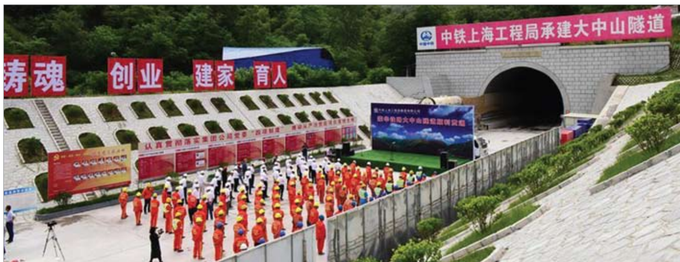
Завершение проходки тоннеля «Дачжуншань» на шаньсийско-хэнаньском участке железной дороги «Мэнхуа», 27 мая 2018 г.
