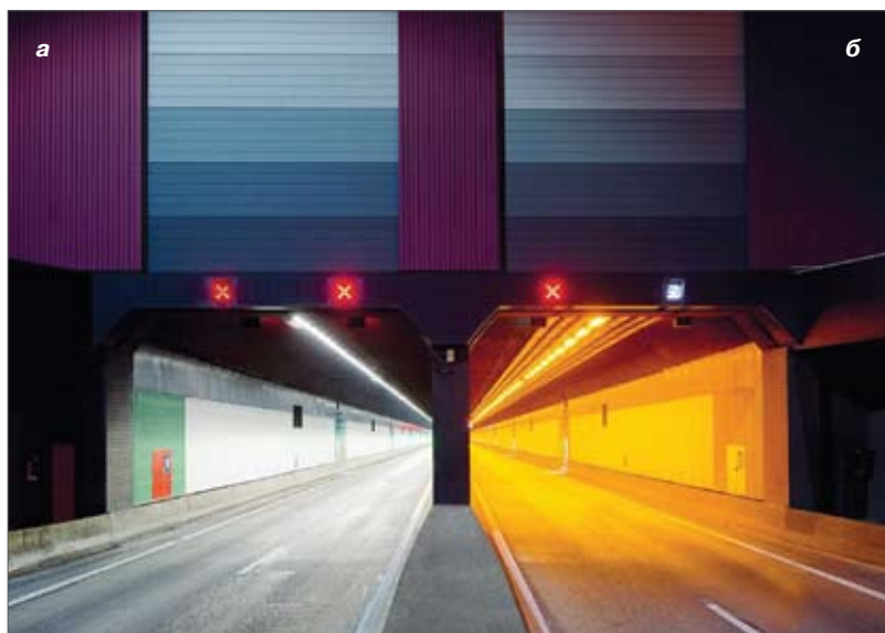
Рис. 4. Варианты освещения тоннелей с использованием светильников с натриевыми лампами (а) и светодиодных светильников (б)
