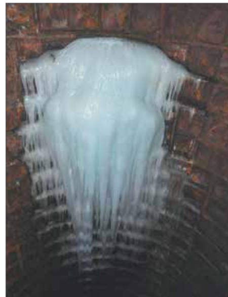
Рис. 4. Пример обледенения участка чугунной тубинговой обделки ствола шахтной вентиляции.
