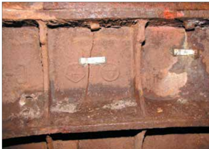
Рис. 6. Пример наличия трещин в спинке, ребрах и бортах тубинга чугунной обделки ствола шахтной вентиляции. Установлены маяки для контроля за динамикой раскрытия трещин
