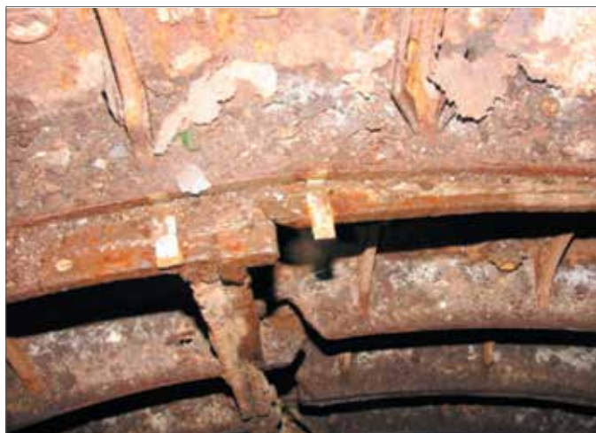
Рис. 8. Пример наличия излома тубингов чугунной обделки ствола шахтной вентиляции со смещением внутрь ствола
