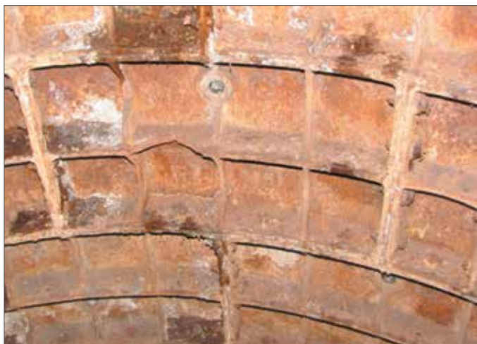
Рис. 7. Пример наличия скола части радиального ребра тубинга чугунной обделки ствола шахтной вентиляции
