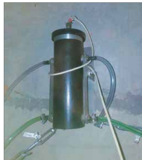
Рис. 2. Установленный датчик гидростатического нивелирования
