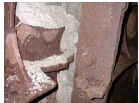
Рис. 1. Пример разрушения кольца обделки вентиляционного ствола в результате замерзания воды и грунта за обделкой
