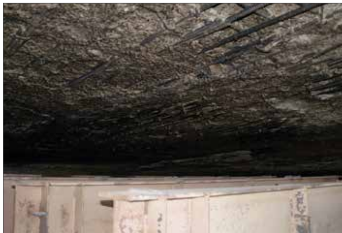
Рис. 3. Около 1200 м 2 бетона было повреждено во время пожара при строительстве моста через бухту Золотой Рог. Причина – взрывообразное (хрупкое) разрушение бетона. Был осуществлен гидродемонтаж бетона.
