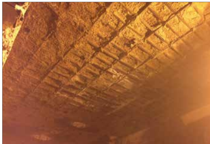
Рис. 4. Результаты пожара в строящейся переходной камере московского метрополитена, январь 2019 года
