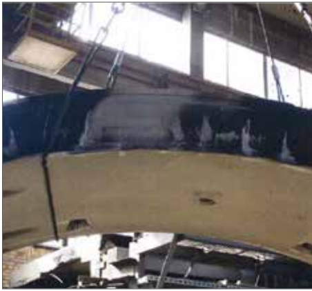
Рис. 5. Железобетонный тубинг из бетона без добавки полипропиленовой микрофибры после огневых испытаний
