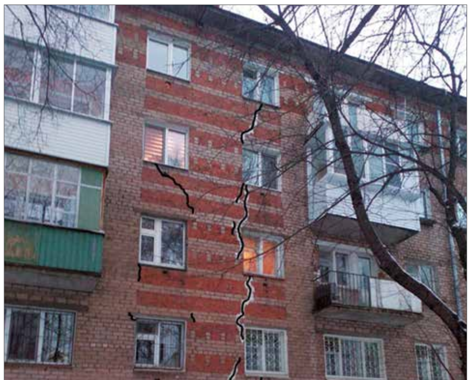
Рис. 2. Характерные места развития трещин на зданиях
