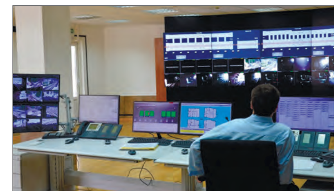
Рис. 2. Расположение отдельного автоматизированного рабочего места (АРМ) геотехнического мониторинга в диспетчерской
