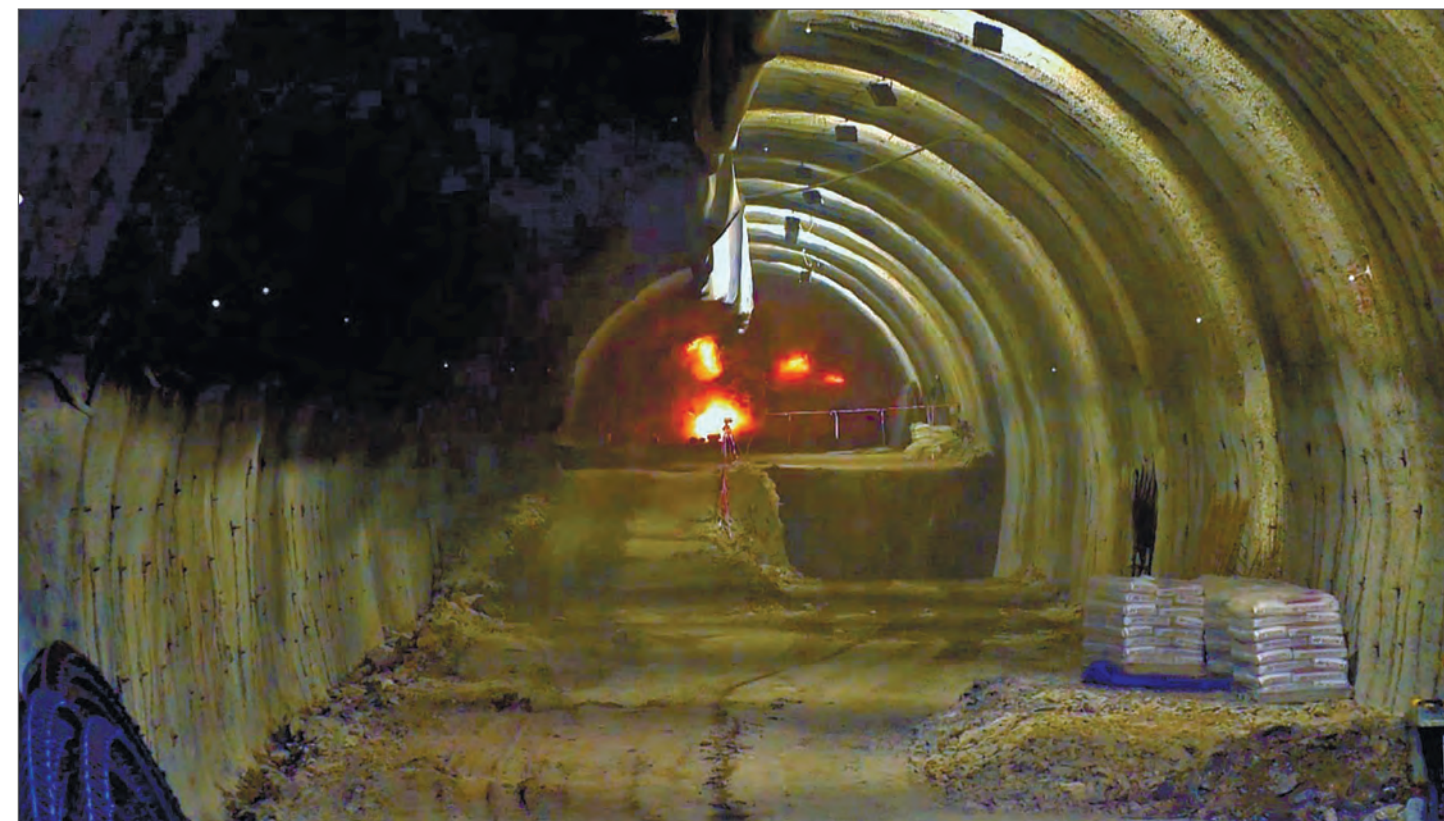
Рис. 1. Пожар в строящемся тоннеле
