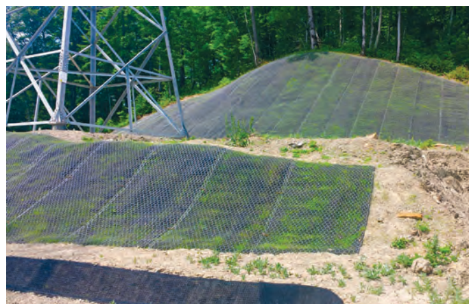
Противоэрозионная защита, выполненная в районе расположения опоры ВЛ
