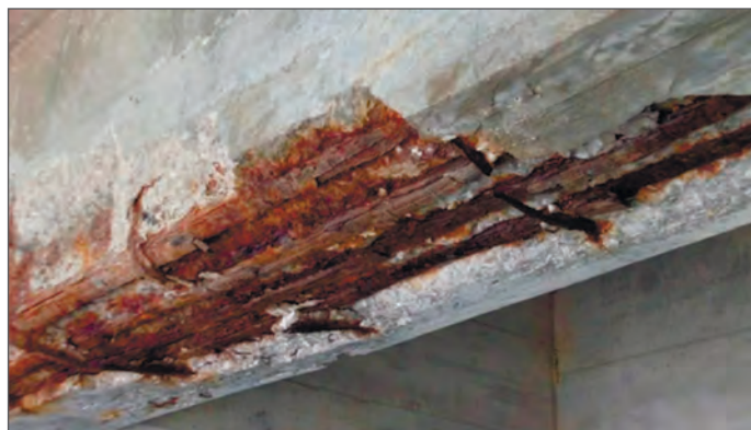
Рис. 2. Коррозия арматуры в нижней зоне балки
