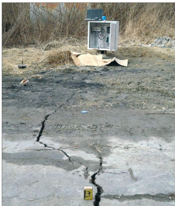
Рис. 4. Трещина на поверхности земли при выполнении нагнетания тампонажного раствора за обделку
