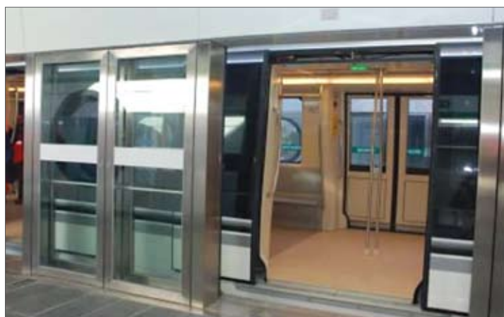
Рис. 12. Автоматические двери на станции линии С
