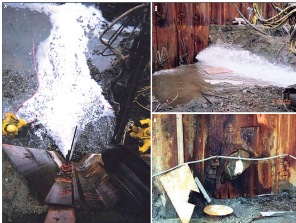
Рис. 3. Разрушение металлического шпунтового ограждения при строительстве подземного паркинга в Ванкувере, Канада
