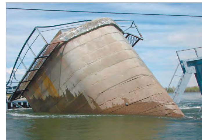
Рис. 4. Пример крена опоры моста под железную дорогу
