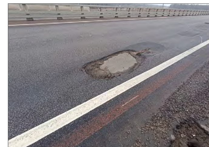
Фото 6. Дефект «Низкокачественное битумное вяжущее»
