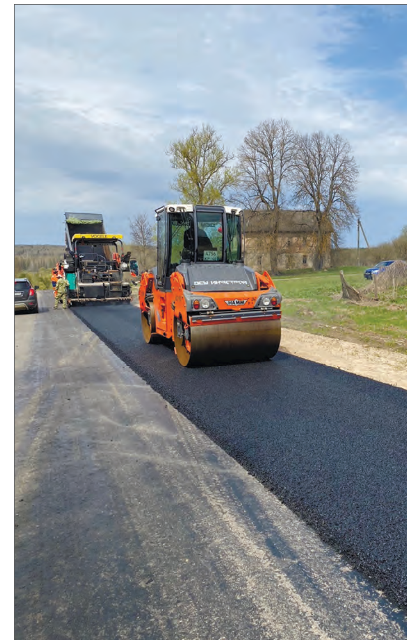
Выполнение работ по ремонту автомобильной дороги М-3 «Украина» — Усты — Палики в Думиничском районе на участке с км 0+000 по км 6+440
