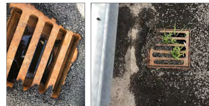
Фото 1, 2. Забитые водоотводные воронки. Дренажные системы не работают. Фото выполнены на разных объектах
