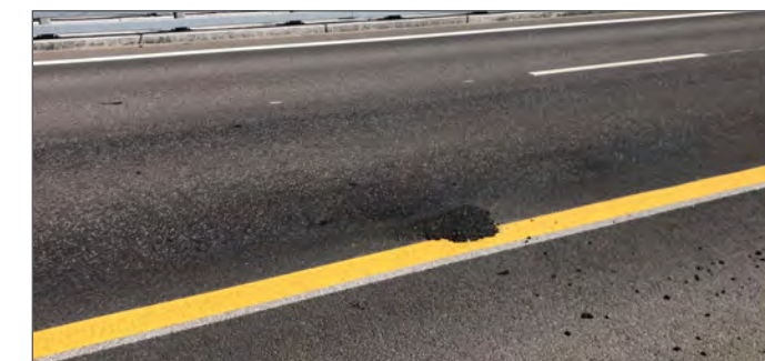
Рис. 5. Дефект «Несоответствие смесей условиям работы»
