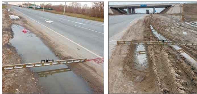
Рис. 5. Дефекты покрытия обочины над трассой ЛКС на дорогах М-5 «Урал» и Р-229 в весенний период
