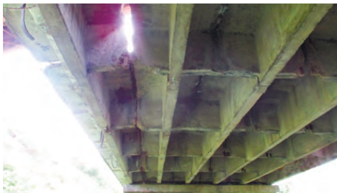
Фото 3. Нарушение объединения крайних балок, крен балки с образованием сквозной щели в мостовом полотне
