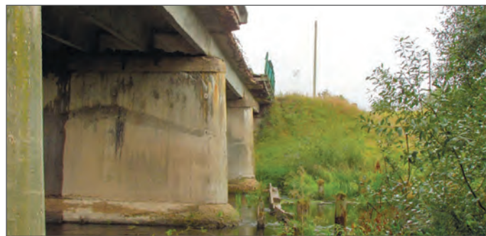
Фото 1. Обрушение тротуарных блоков вследствие коррозионного разрушения консолей балок.
