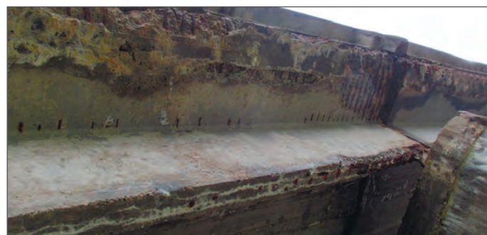
Фото 2. Многочисленные области морозного разрушения бетона, пластовая коррозия рабочей арматуры в зоне опирания и продольные коррозионные трещины с выщелачиванием бетона
