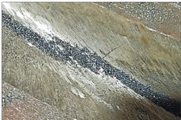
Рис. 6. Поперечная трещина (фрагмент)
